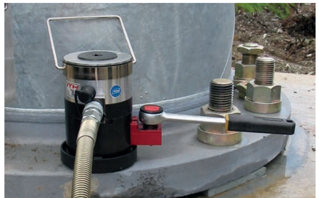
Fundamentverschraubung eines Seilbahnmastes mit ITH SSZ Typ ES und integrierter kardanischer Scheibe in der Abstützung.
