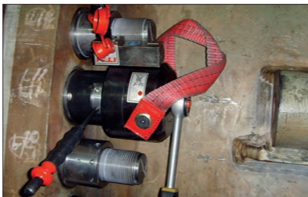
Gehäuseverschraubung einer Turbine mit ITH SSZ Typ ES, Rundmutter mit Radialbohrungen und Beistellöffnung in der Abstützung.
